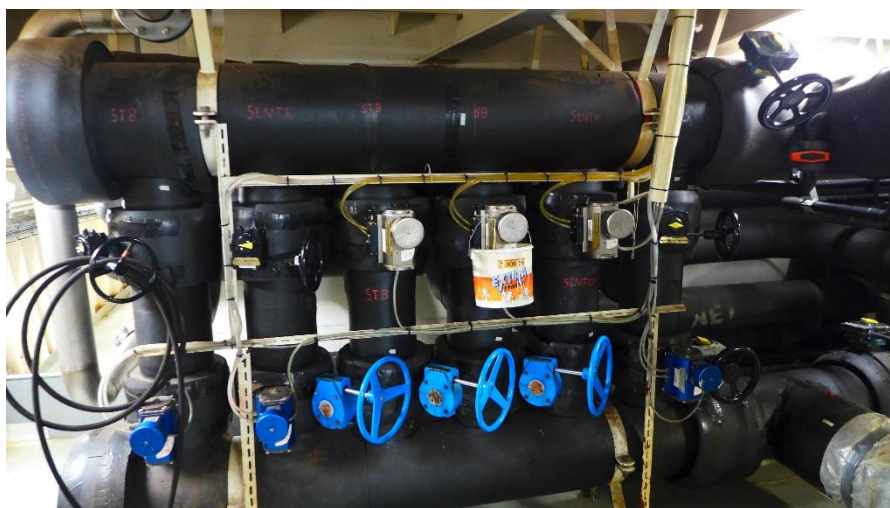
Figur 6. Styring av sirkulasjonspumper i seksjon 3 med de tre største tankene på 300 m 3
